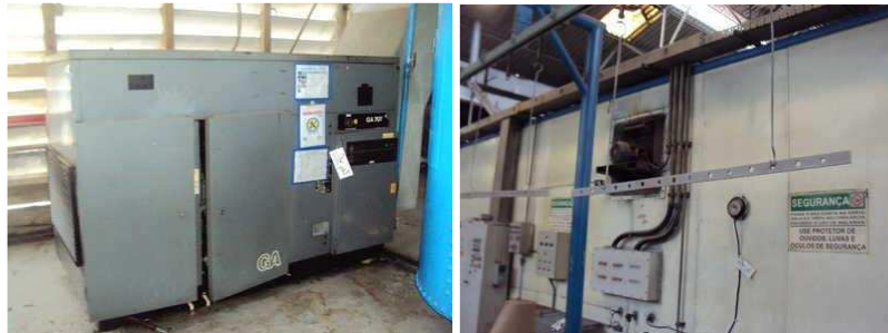
Compressor de Ar Estacionário e Linha de Pintura a Pó
